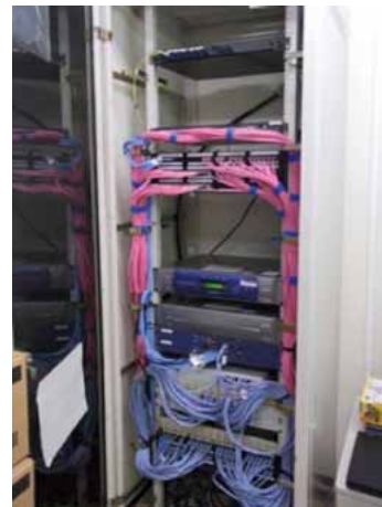
図5 メディア資料室のネットワーク機器（C棟）
