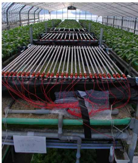
図 5.2.2.1 栽培区画への円筒形 PV の設置(手前の区画から 28 本、14 本、7 本の円筒形 PV を設置)
