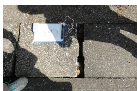
(a) U 字溝間に生じた隙間
