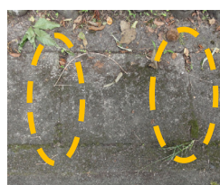
(b) 土砂堆積による被覆
