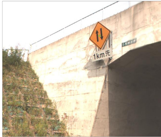
図 2-4 柱状物を用いずに設置された道路標識
